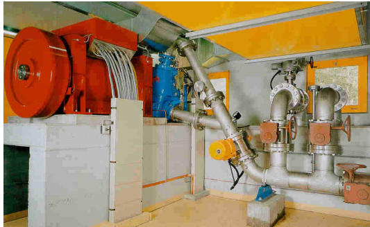
Ancien groupe 665 kW – 240 l/s -585'000 kWh/an
