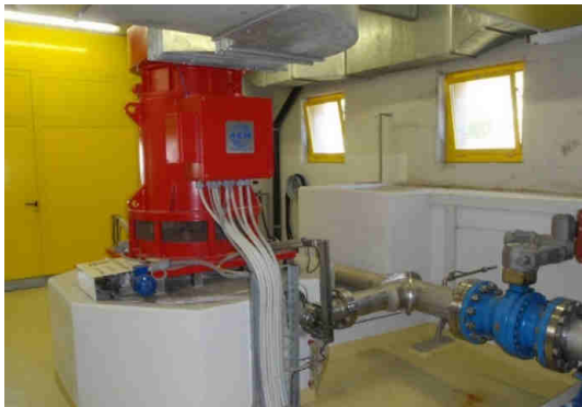
Nouveau groupe 380 kW – 100 l/s - 800'000 kWh/an
